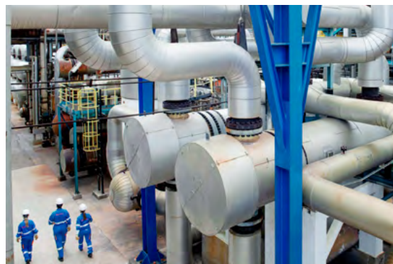
Raffinerie de Grandpuits
